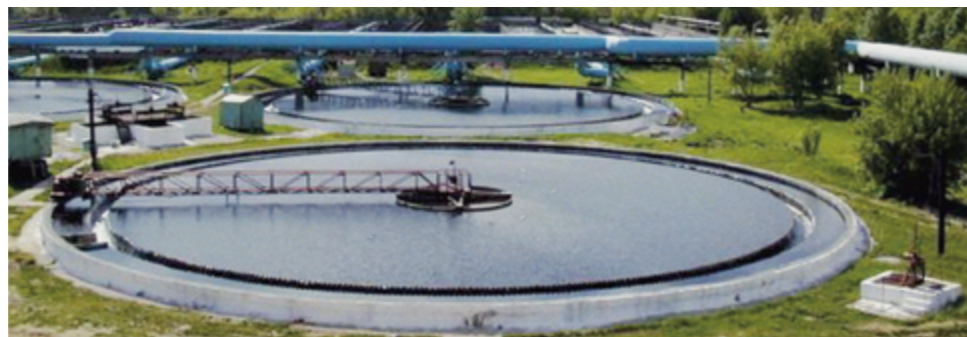
Очистные сооружения «Исток» г. Дзержинск Нижегородская обл.
